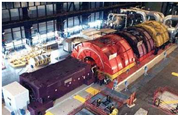
FIGURE 5 – Alternateur dans une centrale électrique
